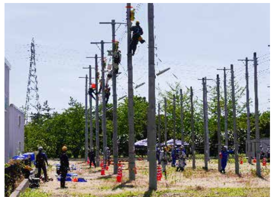
作業台の位置が高くて充電部に接近
